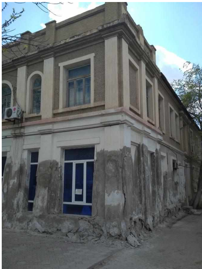
Рис 2. - Характер разрушения здания по ул. А.Шамуратовой г. Нукуса (2018 г)
